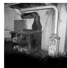
Cuisine et chaudière de chauffage central.
